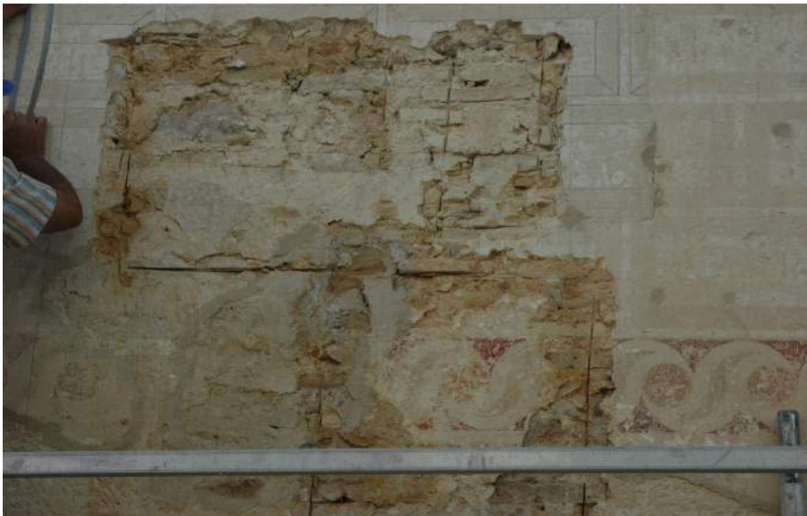
Imágenes del estado inicial del paramento con evidencia de separación de los revocos del soporte.
