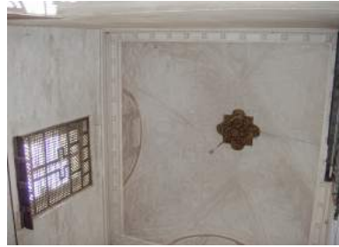
Bóveda tabicada esquinada que cubre la escalera principal del Palacio del siglo XVIII, con la celosía en el hueco hacia el callejón de los Félix.
