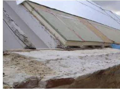
Lámina de aislante reflectivo colocada sobre el nuevo entablado de paneles aislantes machihembrados.
