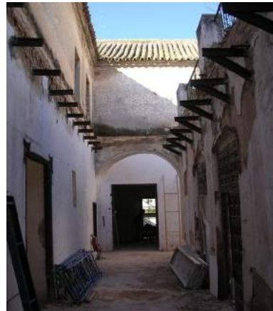
Restos de ménsulas metálicas oxidadas en la galería alta de la casa, que fueron eliminadas para la ejecución del nuevo forjado.
