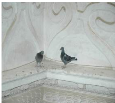
Cornisa con presencia de suciedad y palomina.
