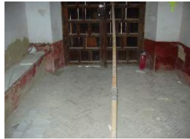
Estado inicial de la solería del zaguán del Palacio del siglo XVIII.
