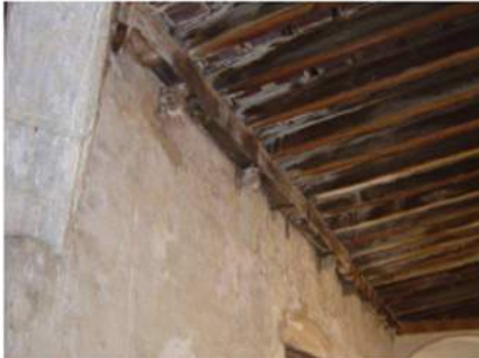
Humedades por filtraciones en muros con desprendimiento del revestimiento y deterioro de la madera que apoya en los mismos.
