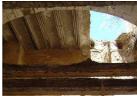
Forjado notablemente deteriorado, incluso desaparición de viguetas de madera y revoltones de yeso.
