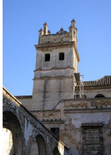
Estado de la torre, previo a los trabajos de rehabilitación.
