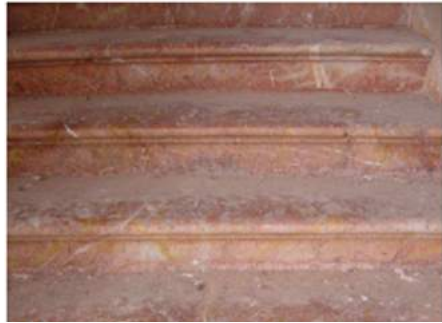
Peldaños de mármol desgastado y muy deteriorado.
