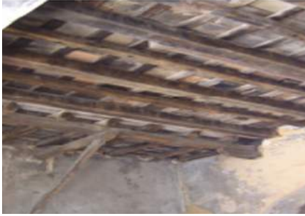
Mal estado de conservación y de mantenimiento del forjado de madera y desprendimientos del revestimiento en paramentos.
