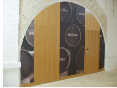
Cerramiento de roble americano en los arcos de la bodega.
