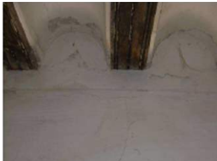
Fisuras en muro coincidentes con la entrega de viguetas.
