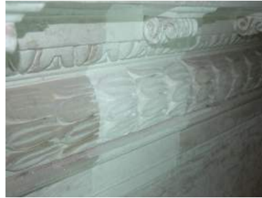
Limpeza y cala estratigráfica para búsqueda de pintura en la cornisa del arranque de la bóveda.
