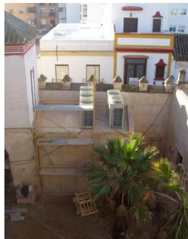
Equipos de climatización de sistema VRV, instalados sobre el centro de transformación.
