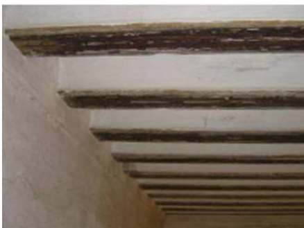
Fisuras en el entrevigado, perpendiculares a las viguetas.
