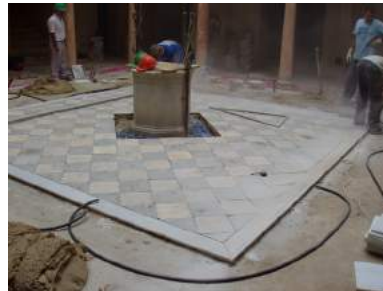
Colocación de las piezas de mármol recuperado en forma de «alfombra» central.
