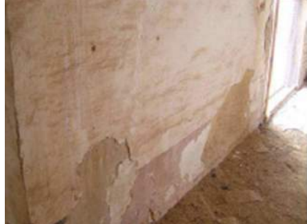
Desprendimientos del revestimiento (mortero y pintura) en paramentos.
