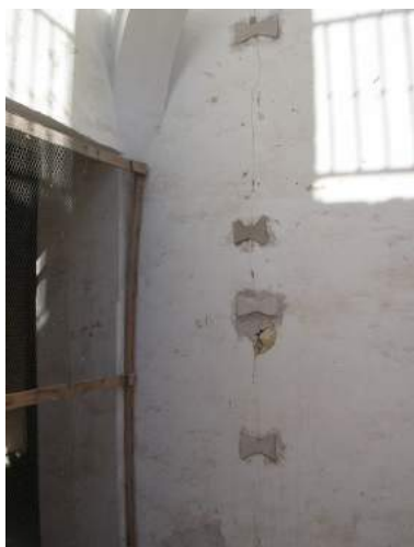
Testigos de yeso para monitorizar el comportamiento de las fisuras.
