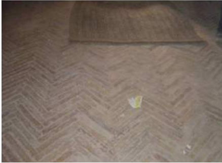
Deformación de la solería de ladrillo del zaguán de la entrada principal del Palacio, como consecuencia del hundimiento del terreno.
