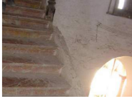
Ausencia de barandilla.
