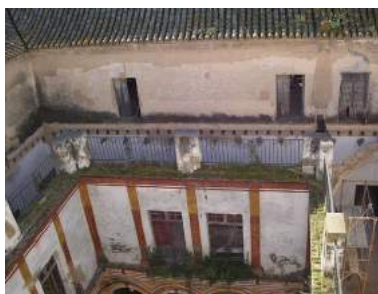
Caracterización de patologías en los muros del Palacio del siglo XVIII.
