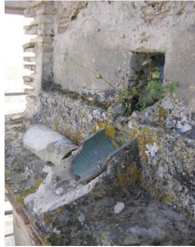
Estado inicial de uno de los vierte-aguas, con roturas y presencia de elementos biológica.
