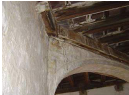
Humedades por filtraciones en arcos, con desprendimiento del revestimiento y deterioro de la madera que apoya en los mismos.
