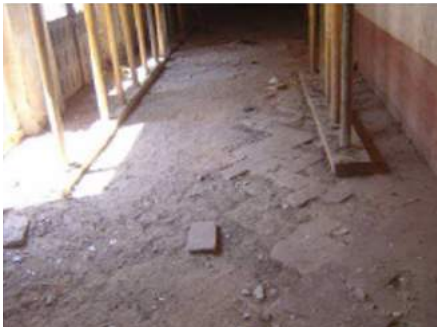
Solería de ladrillo macizo colocada a la portuguesa con falta de planicidad, presentando rotura y ausencia de piezas cerámicas.
