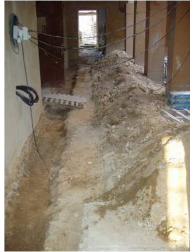
Ejecución de un anillo perimetral para albergar las instalaciones, tanto en las galerías de planta baja como en las de planta segunda, dentro del Palacio del siglo XVIII.
