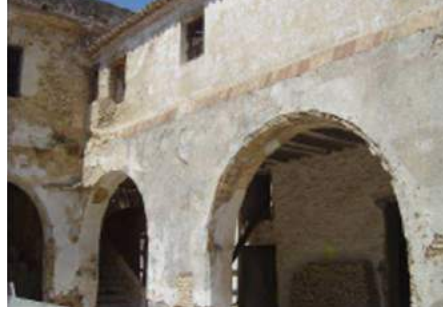
Desprendimiento del revestimiento en paramentos, falta de mantenimiento y de conservación y ausencia del entrevigado del forjado.
