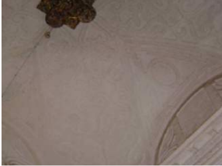
Fisura en bóveda esquifada.
