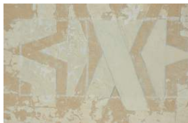
Estado inicial del trazo de lacerías en la pintura mural.
