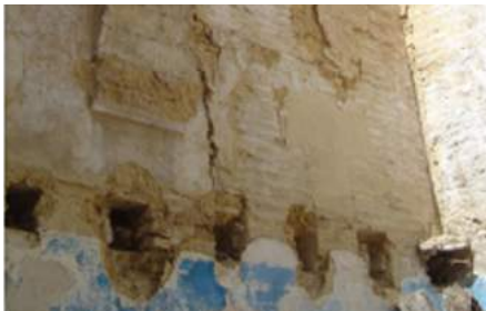
Pérdida total del forjado (vigas de madera y entrevigado de madera), desprendimiento del revestimiento y fisura vertical de grandes dimensiones en paramento.
