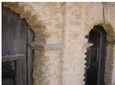
Estado inicial de las carpinterías, con presencia de ataque de insectos xilófagos.
