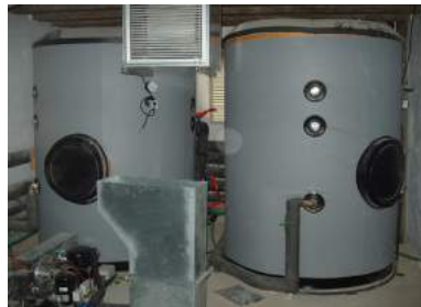
Sistema de producción de agua caliente sanitaria, formado por calderas a gas y depósitos acumuladores.
