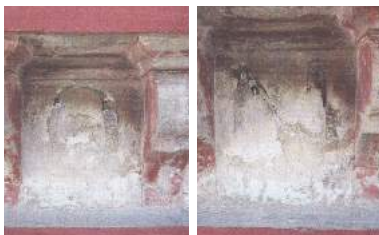
Estado inicial de las policromías de letras situadas en la cornisa de la torre y que contenían la fecha de su construcción.
